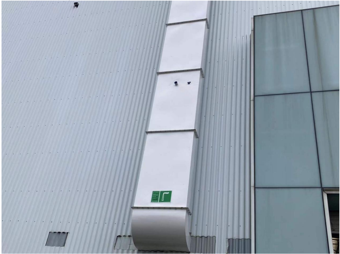
抛丸废气排气筒
