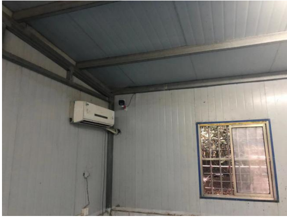
危废仓库摄像及通风装置
